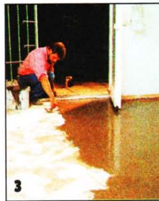
3 При выравнивании основания самовыравнивающимся раствором заодно заполнятся и трещины. Если раствор — быстротвердеющий, покрытие можно класть уже через два часа.
