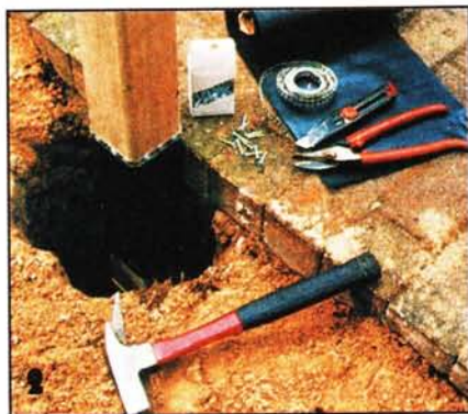
Стойку снизу обматывают плёнкой. Верхний край плёнки крепят перфорированной лентой и гвоздями.
