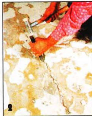
2 Образовавшиеся в цементной стяжке трещины необходимо заделать, иначе на новом покрытии будут заметны их следы.
