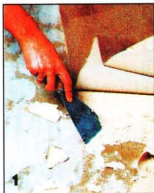
1 При замене старого покрытия пола на новое (из сизального волокна) следует прежде всего подготовить основание, которое должно быть сухим и ровным. Прилипшие к основанию частицы старого покрытия надо полностью удалить.
